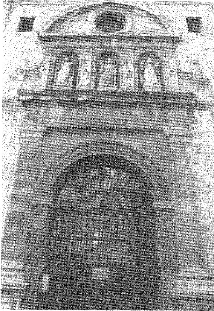
Portada de acceso a la iglesia del Convento de Santo Domingo, restaurada en 1924, bajo la dirección de D. Luis Berges Martínez.
